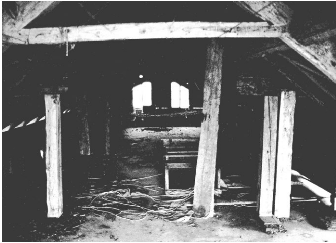
11 Ecoteaux, La Combe: Stall, Blick ins Innere der Lukarne auf dem Stallneubau. Teile der Ständer und Rähmbalken vom ursprünglichen Speicher waren in der Lukarne in Zweitverwendung verbaut. Aufnahme 1985.
